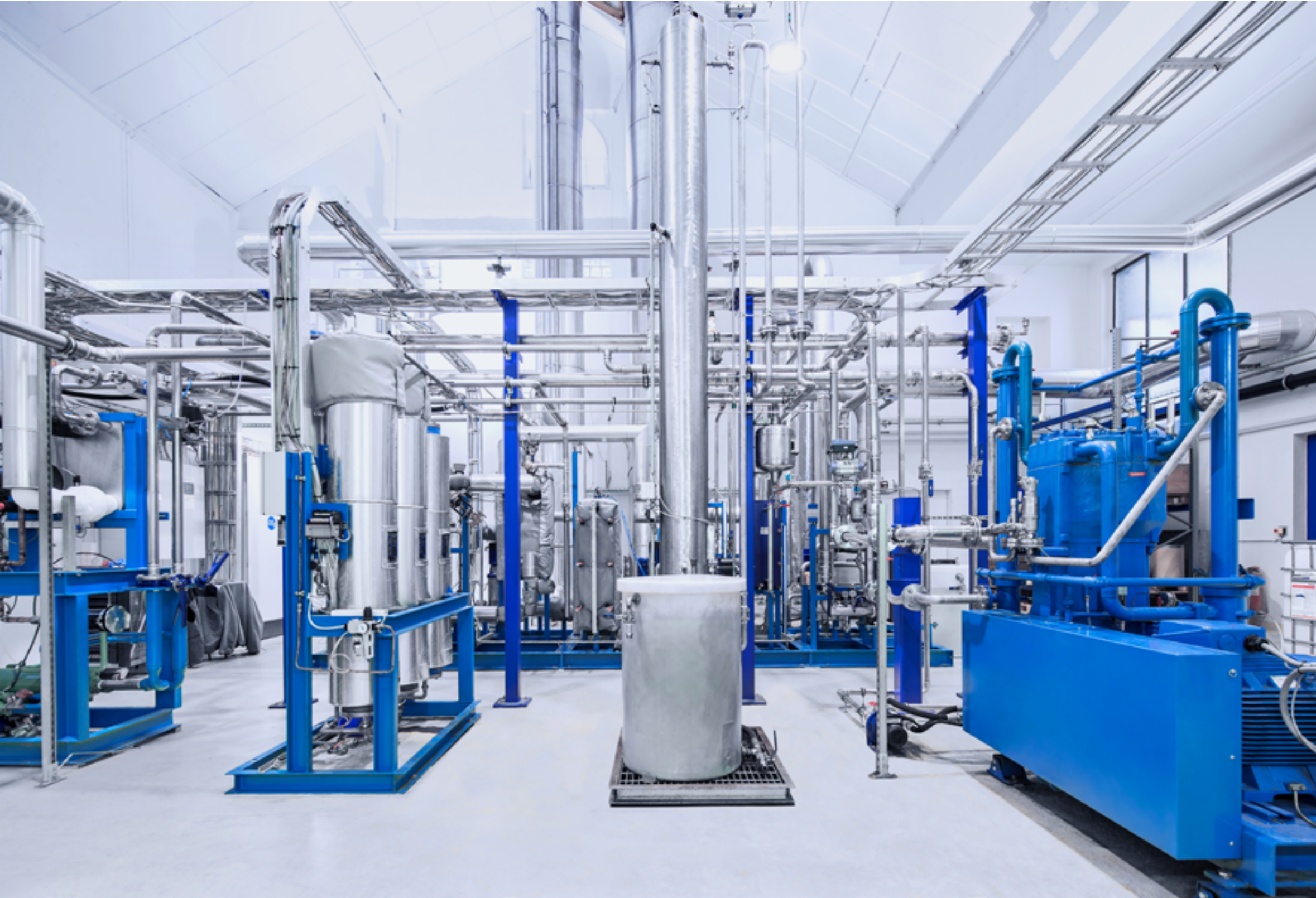
Photo d'exemple d'une installation de récupération de CO 2 de Messer.
